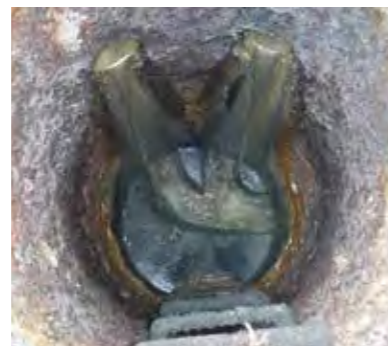
マンホール内の腐食状況
