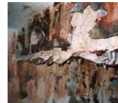
下水処理施設のコンクリート腐食発生箇所
