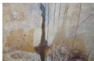
コンクリート躯体の漏水状況
